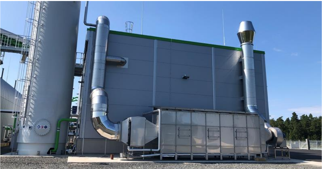
Bild 3: Fotooxidationsanlage Schlammbehandlung, Schweden [6]
